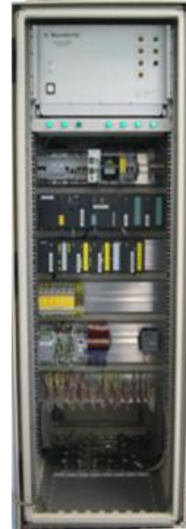
Baie contrôle commande
