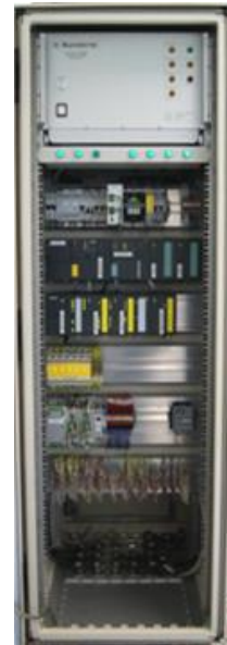
Baie contrôle commande
