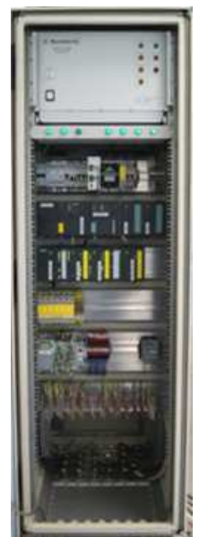
Baie Contrôle Commande
