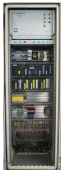
Baie Contrôle Commande
